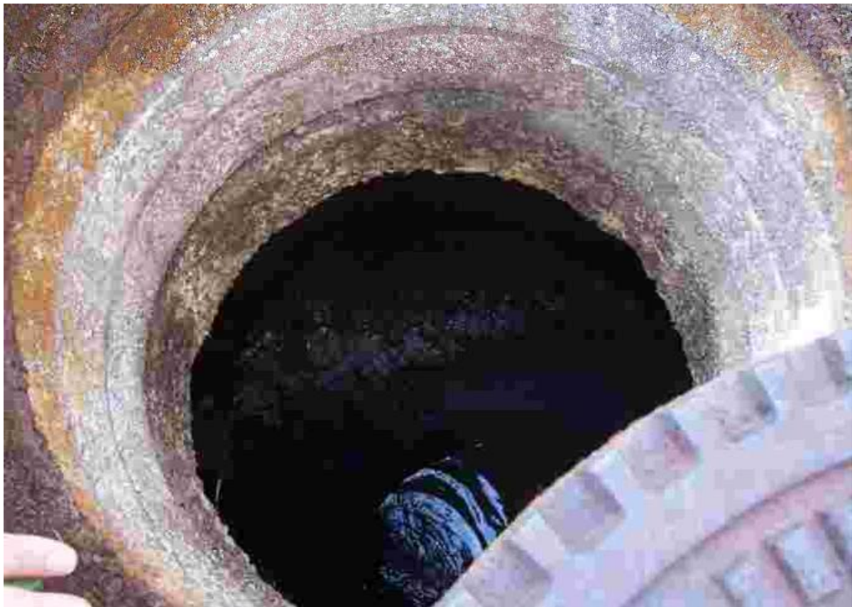
Abbildung 16: Bild des korrodierten Abwasserschachtes (Eigene Darstellung)
