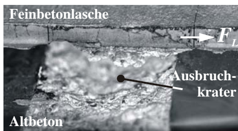
a) Verbundversagen im Altbeton
