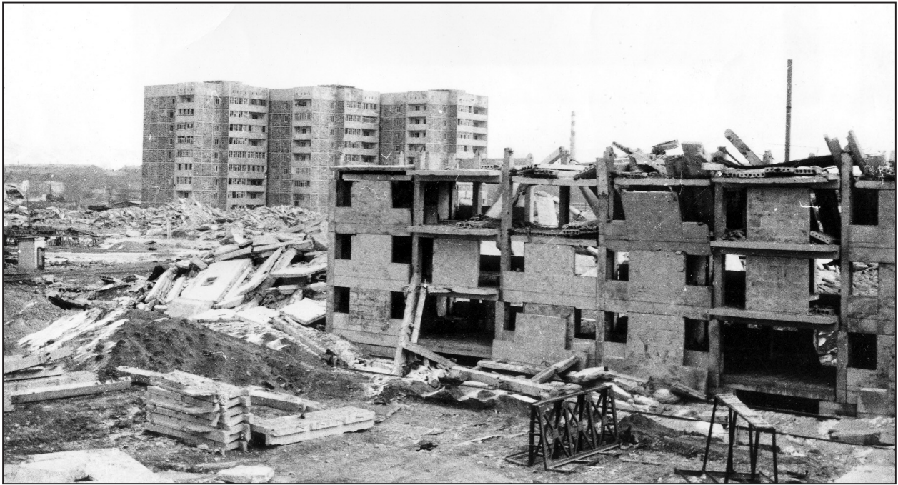
Рис. 6. Повреждения каркасно-панельных жилых домов серии 111 в г. Ленинакане; на заднем плане – крупнопанельные жилые дома серии А1-451кп, перенесшие Спитакское землетрясение практически без повреждений.
