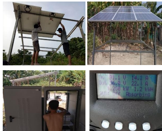
Gambar 4.6 Implementasi Rumah Listrik berbasis Solar Cell
