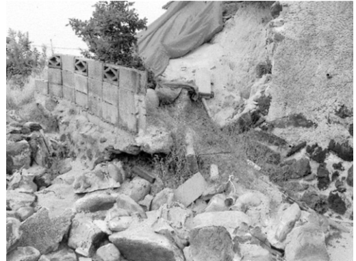
写真14 擁壁ブロック塀崩壊連段による宅地
