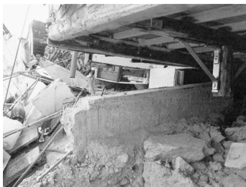
写真8 擁壁崩壊による宅地の流出
