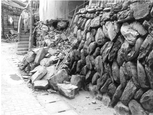
写真11 擁壁崩壊による宅地
