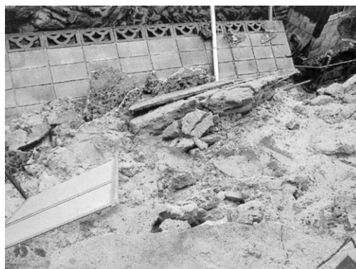
写真10 盛土部用壁崩壊による宅地の崩壊
