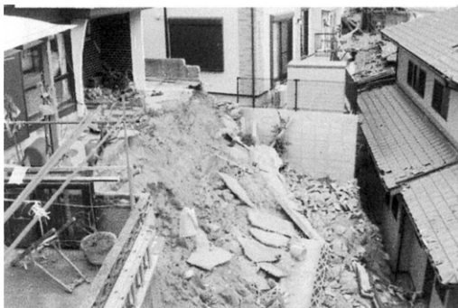
写真13 宅地擁壁の被害
