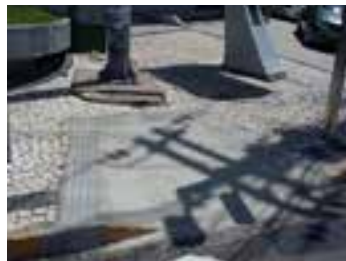
Rampa obstruída por postes.
