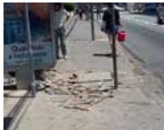
Piso degradado e poste tomando passeio.
