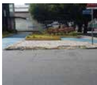
Inexistência de rampa na travessia e piso degradado
