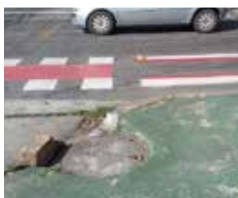
Tampa de esgoto na calçada no ponto de travessia
