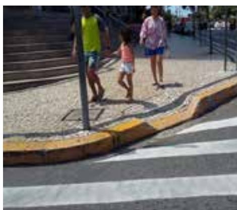
Passeio com dimensões adequadas, porém rampa de acesso inviável.
