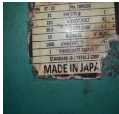
Gambar 7. Generator dan Spesifikasinya
