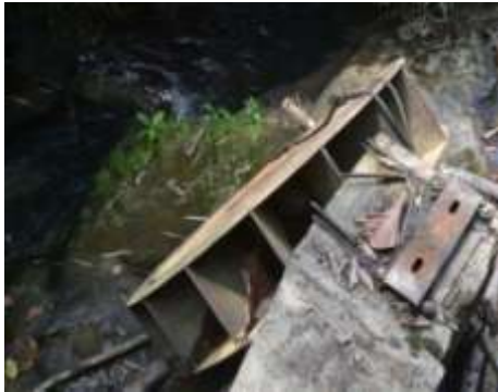
Gambar 3. Posisi turbin yang terdampar
