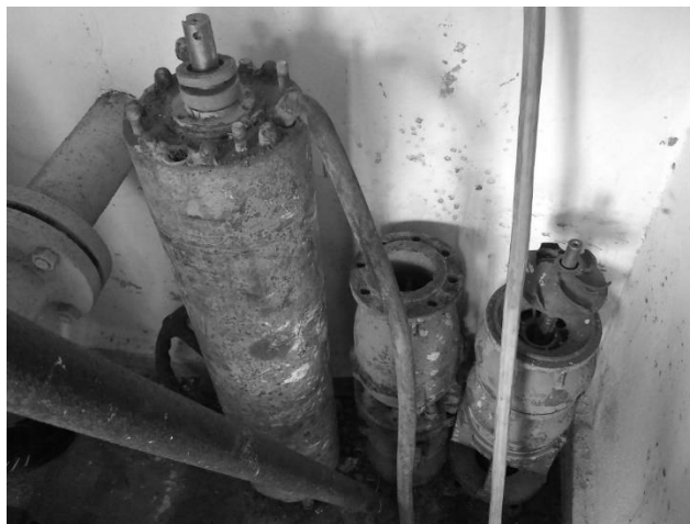
Figura 3. Bomba del sistema de bombeo.
