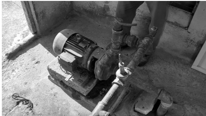
Figura 2. Bomba del sistema de bombeo.
