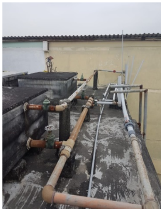
Figura 10. Sector correspondiente a Nivelación. Tanques de agua y redes de agua potable con presencia de óxido en tuberías de metal.
