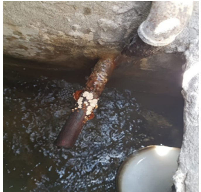
Figura 13. Sobre el área del Decanato. Presencia de hongos dentro de tanque de agua potable.
