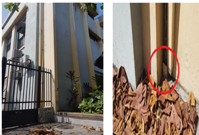
Figura 7. Bajante de aguas lluvias rota en el sector de ASO ESCUELA.
