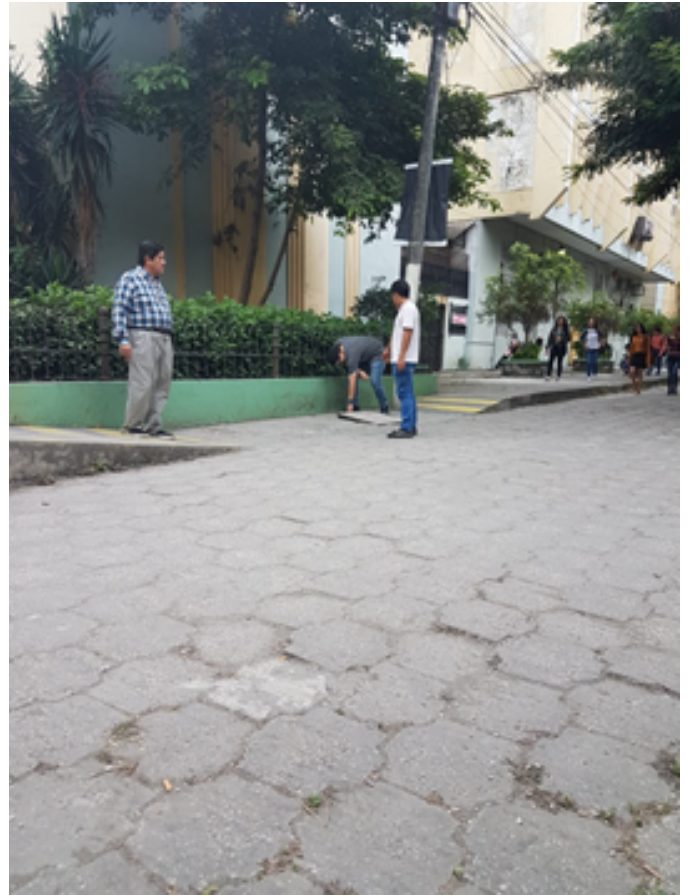
Figura 5. Revisión de cajas de aguas lluvias. Fuente: Elaboración propia.
