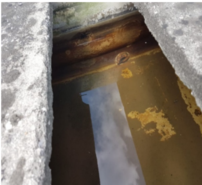
Figura 12. Sector sobre el área del Decanato. Tanques de agua y redes de agua potable con presencia de óxido en tuberías de metal.
