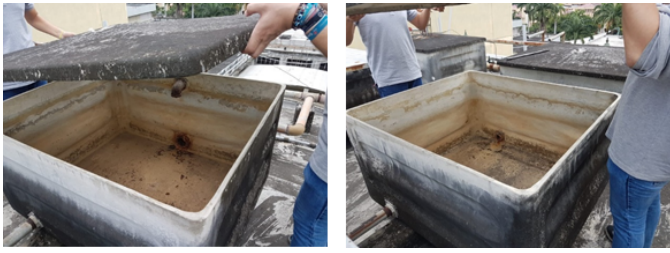
Figura 15. Sector correspondiente al área de Nivelación. Tanque de agua potable vacío, estado deplorable y sin funcionamiento.
