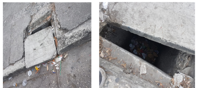
Figura 6. Sumidero taponado al borde de acera causa inundación en la zona.
