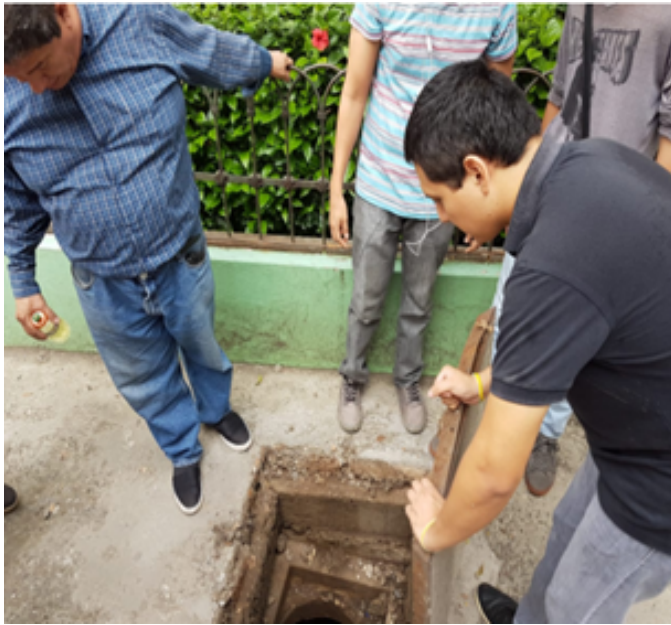
Figura 25. Se puede observar la cámara donde terminan las redes de AASS.
