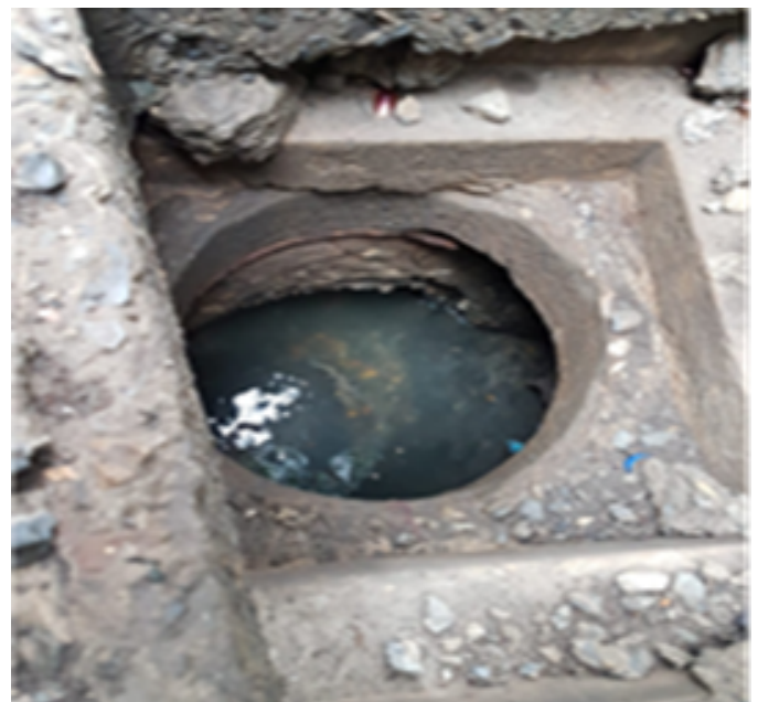
Figura 24. Se puede observar la cámara donde terminan las redes de AASS.
