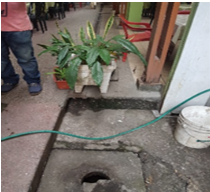
Figura 22. Se puede observar la descarga de la rejilla hacia la caja 4.
