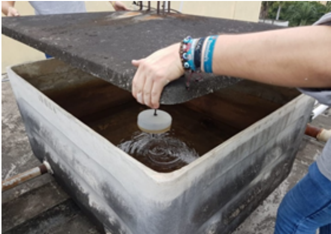
Figura 16. Sector correspondiente al área de Nivelación. Tanque de agua potable lleno, se encuentra en mal estado.
