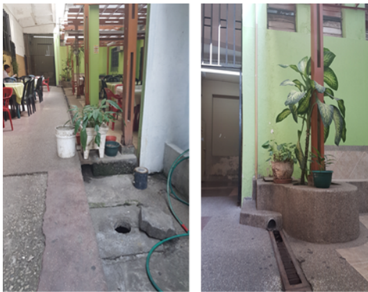
Figura 3. Descargas de aguas lluvias a colector de aguas servidas. Fuente: Elaboración propia.
