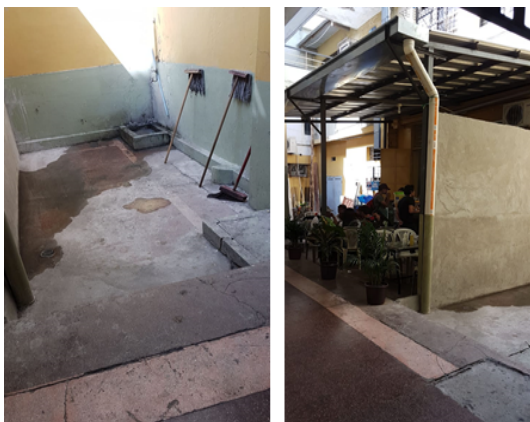
Figura 4. Bajante ilegal de AALL conectado al sistema AASS. Fuente: Elaboración propia.
