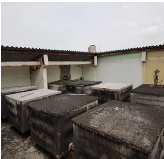
Figura 8. Sector correspondiente a Nivelación. Tanques de agua potable en mal estado.
