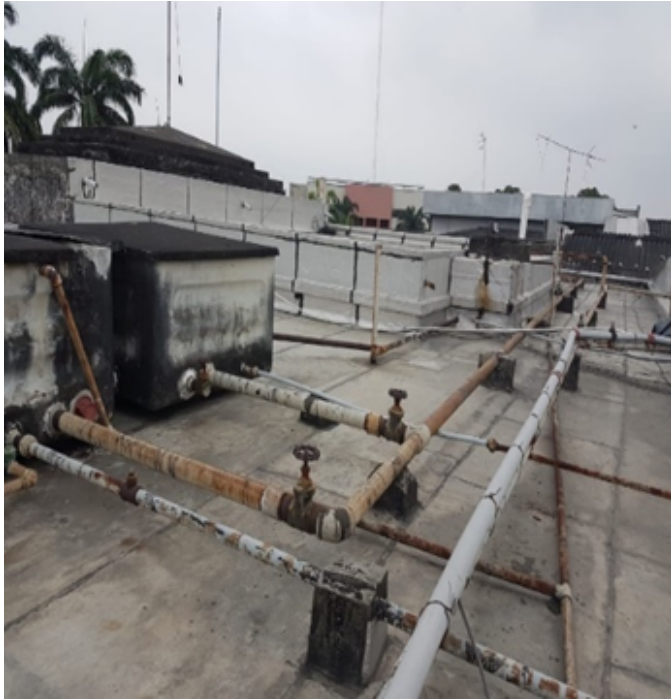
Figura 11. Sector correspondiente a Nivelación. Tanques de agua y redes de agua potable con presencia de óxido en tuberías de metal.
