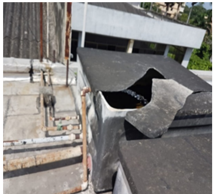
Figura 14. Sector sobre el área del Decanato. Tapa del taque de Agua Potable en mal estado.
