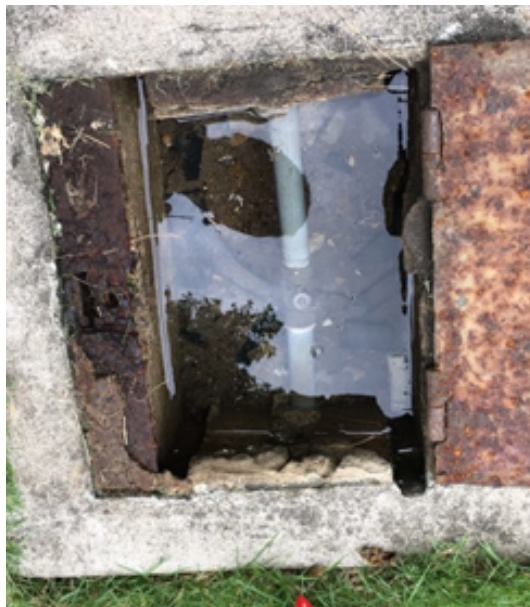
Figura 17. Medidor de agua con presencia de fuga, ubicado en zona verde, al lado oeste de la facultad.
