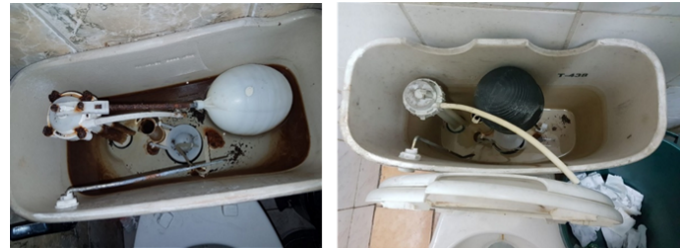
Figura 18. Baño de docentes y baño de damas (Semestral). Ambos inodoros sin agua dentro de su respectivo tanque.
