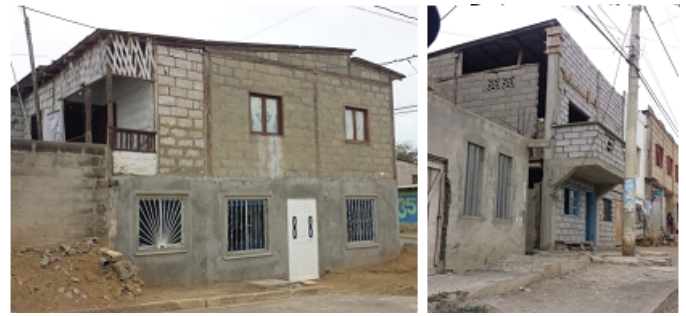
Figura 6. Viviendas de Anconcito donde se puede apreciar las fallas que se pueden ocasionar en caso de un sismo, figura-izquierda: colapso de mampostería, figura derecha: entrespico suave y colapso de mampostería.
