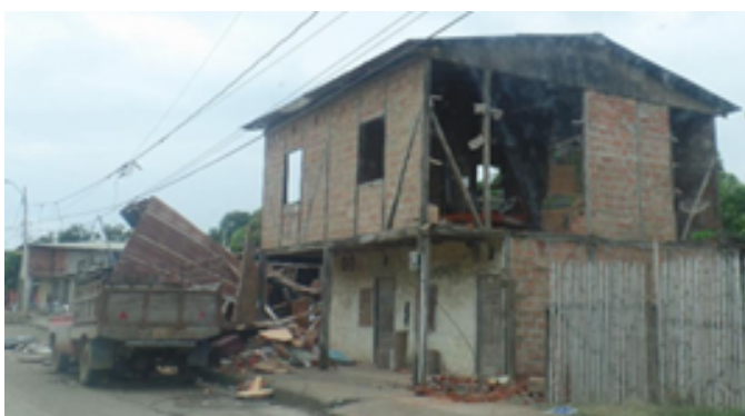
Figura 5. Colapso de mampostería (fuera de plano) en Jama, Ecuador, en el evento sísmico de Muisne del 16 de abril del 2016. Fuente: Rojas (2016).
