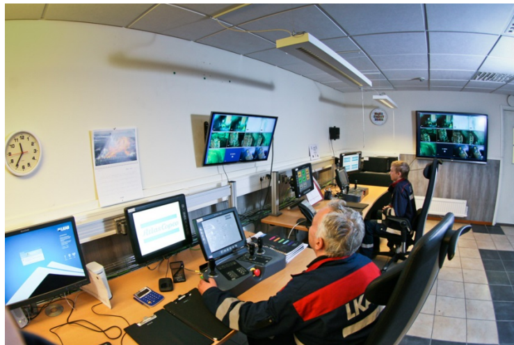
Abb. 6: Kontroll – und Steuerungsraum für Bohrgeräte (Foto: Atlas Copco, LKAB)
