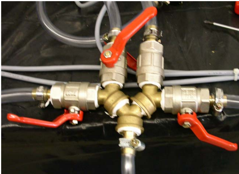
Abb. 6: Vierfachverteilung der Druckluft
