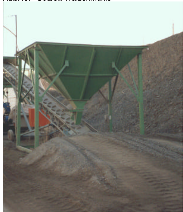
Abb.41: Aufgabebunker mit einem Fassungsvermögen von 5 m 3
