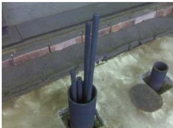
FIGURA 7 - Saída de vapor e ponta da sonda de oxigênio
