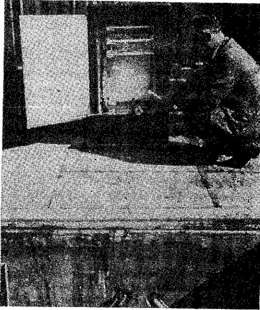
Rys. 2. Nowa szafka kablowa. Podziemna komora szafki zawierała zwykle wiele złączy kablowych, których liczba dzięki nowej metodzie połączeń została zredukowana do minimum
