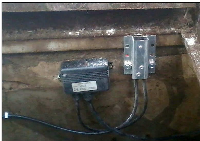
Rys. 19. Czujka i czujnik kontaktronowy w studni kablowej (Brwinów, wrzesień 2013)
