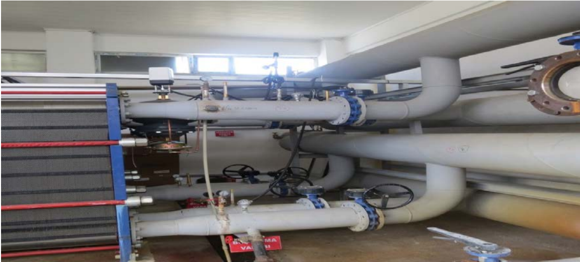
Figure 3: 101 Evler heat center
