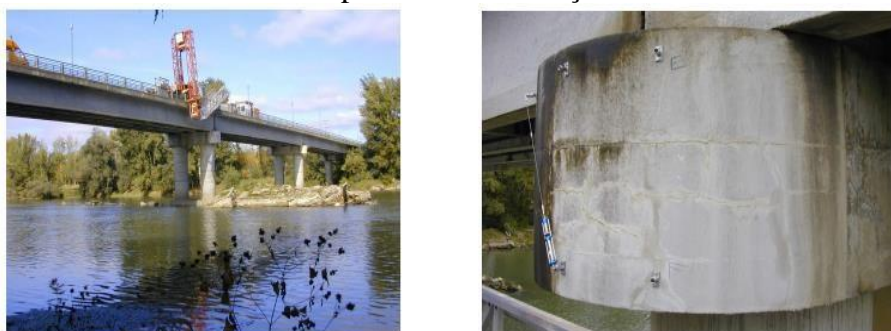
Figura 3– A esquerda visão geral da ponte e a direita visão do fim da viga da ponte Ondes com possível deterioração
