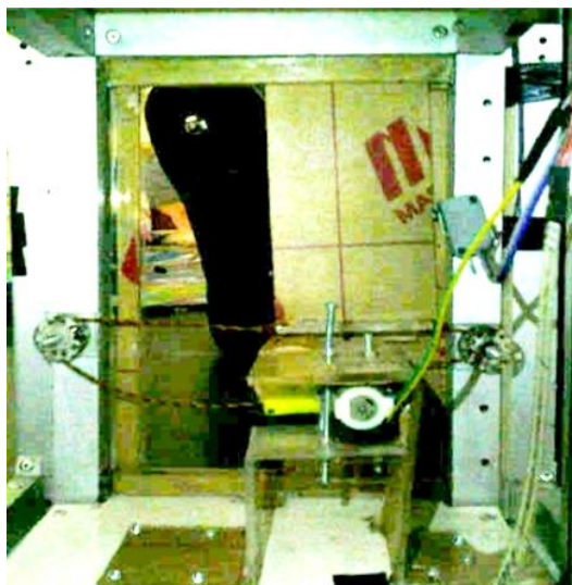
Gambar 5. Pintu Lift Tampak Dalam
