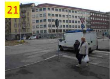
21 Corso Principe Oddone. L'area di cantiere rende difficoltosi gli attraversamenti pedonali, visto anche l'elevato traffico privo di impianto semaforico.
