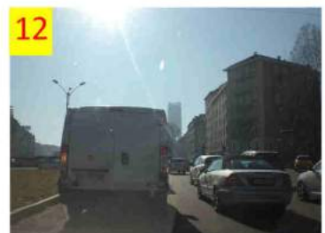
12 Corso Principe Oddone verso Piazza Statuto. A lavori conclusi un sottopasso permetterà di congiungere la strada con Corso Inghilterra
