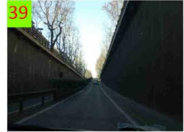
39 Uscita dal sottopasso. Un'opera recente ma troppo stretta per il traffico quotidiano
