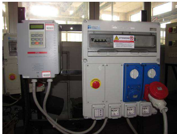
Figura 25: Pompa di alimentazione ed inverter. Circuito B.
