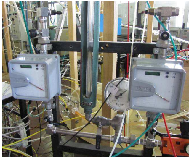
Figura 41: Asimetri elettronici per la misura delle portate di aria. Circuito B.
