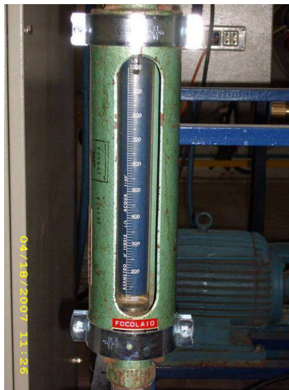
Figura 40: Rotametro 2 per la misura della portata di acqua. Circuito A.
