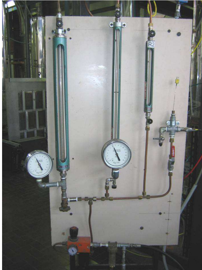
Figura 38: Asametri per la misura della portata di aria. Circuito A.
