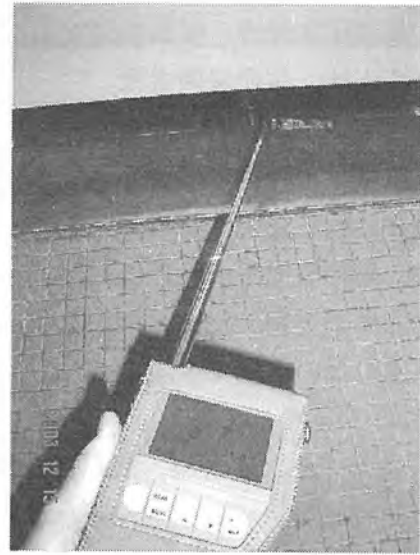
写真A 4. ドア下の隙間（幅 9cm） 風速 3.3～3.7m/秒
