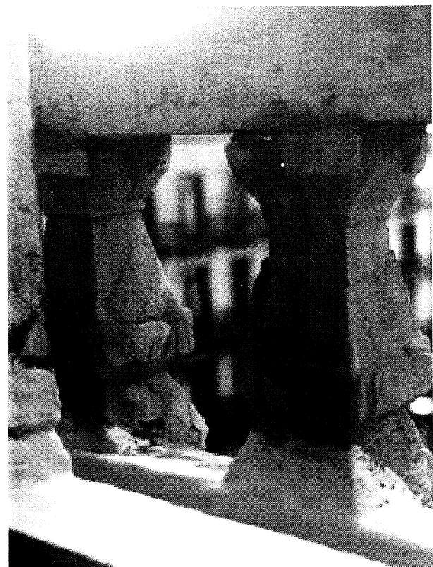
Figura 4.- Erosión y fracturación de los pilares de una balconada del PDFG.
