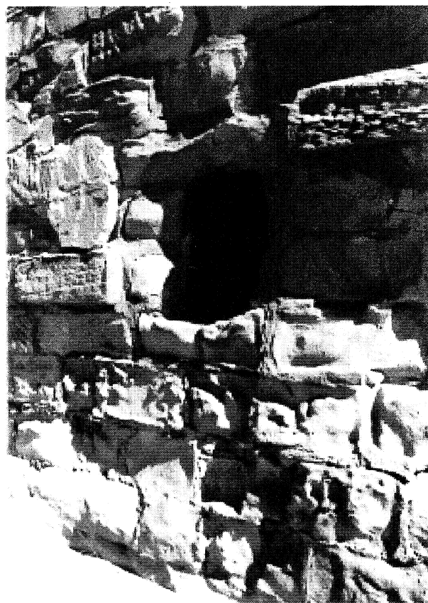
Figura 2.- Erosión diferencial de los sillares de la CAO.
