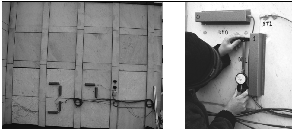
Figura 2. Estación de control del Ayuntamiento de Nyköping. Figure 2. Monitoring station at Nyköping City Hall.
