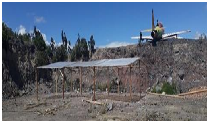
Fotografía 12-2 Cubierta para el desarrollo del compostaje Realizado por: Byron Ruiz y Marco Tixe, 2018.
