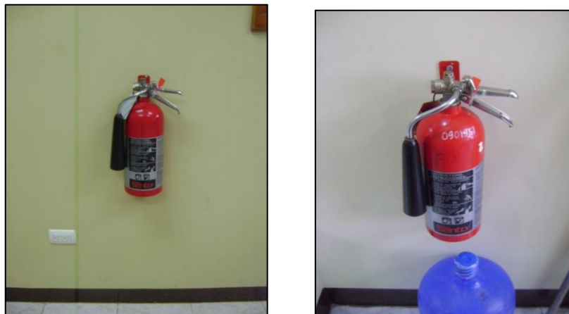
Figura 45. Falta de señalización de los extintores
