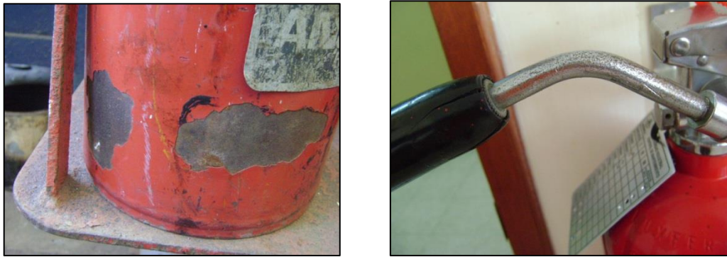
Figura 46. Daño físico y de corrosión de los extintores
