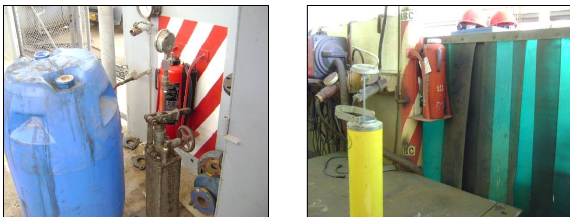
Figura 48. Obstrucciones de acceso a extintor
