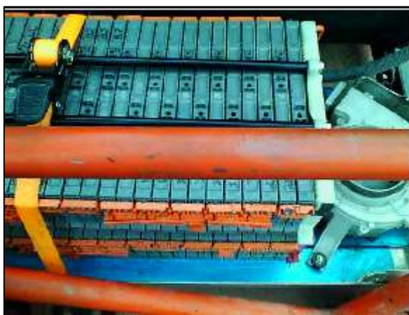
Figura 41-3: Foto de identificación de la fuente de alimentación de energía.
