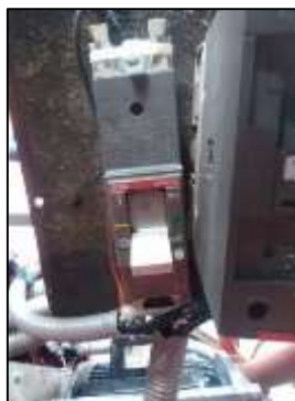
Figura 33-3: Interruptor en modo off
