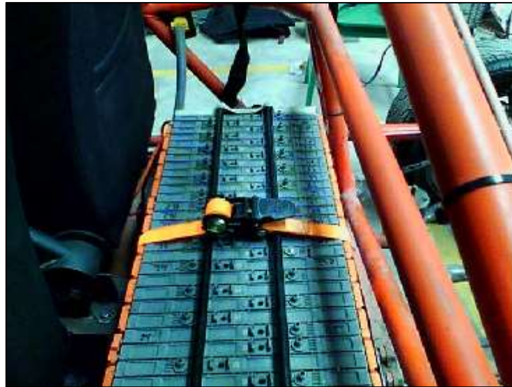
Figura 43-3: Foto de identificación de la fuente de alimentación de energía.
