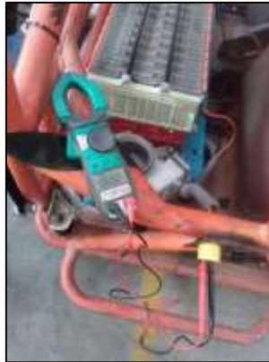
Figura 32-3: Verificación de voltaje
