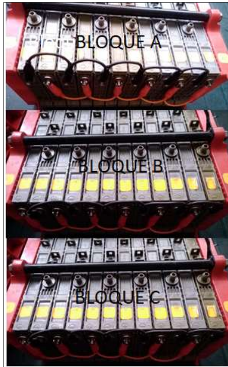
Figura 31-3: Ecuilización de cada uno de los bloques de baterías
