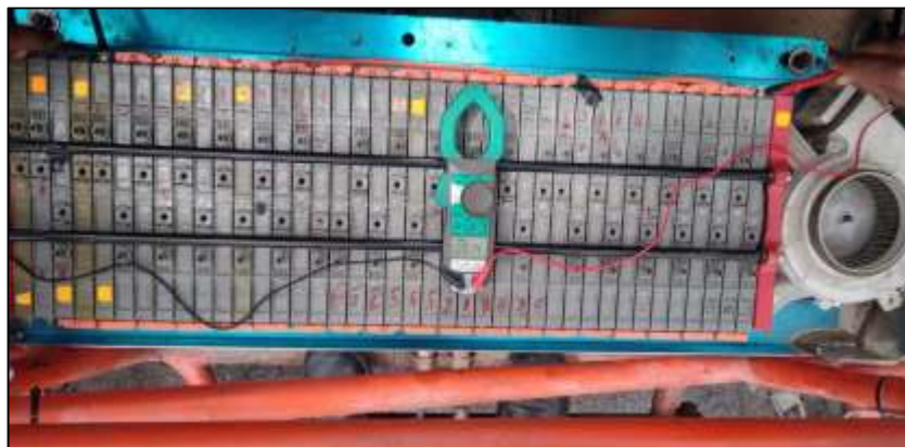
Figura 48-3: Verificación del voltaje antes de realizar la prueba
