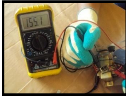
Figura 85. Comprobando continuidad a la entrada del motorreductor
