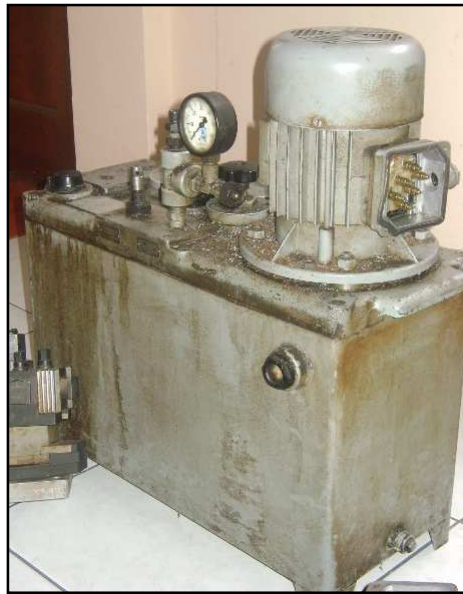
Figura 4.17: Unidad de potencia
