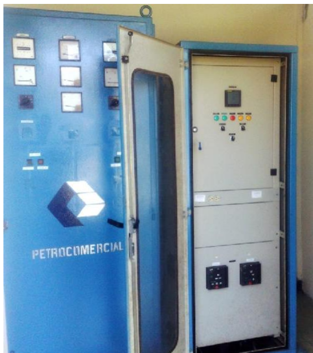
Figura 3.27. Caseta en el que se encuentra el panel.
