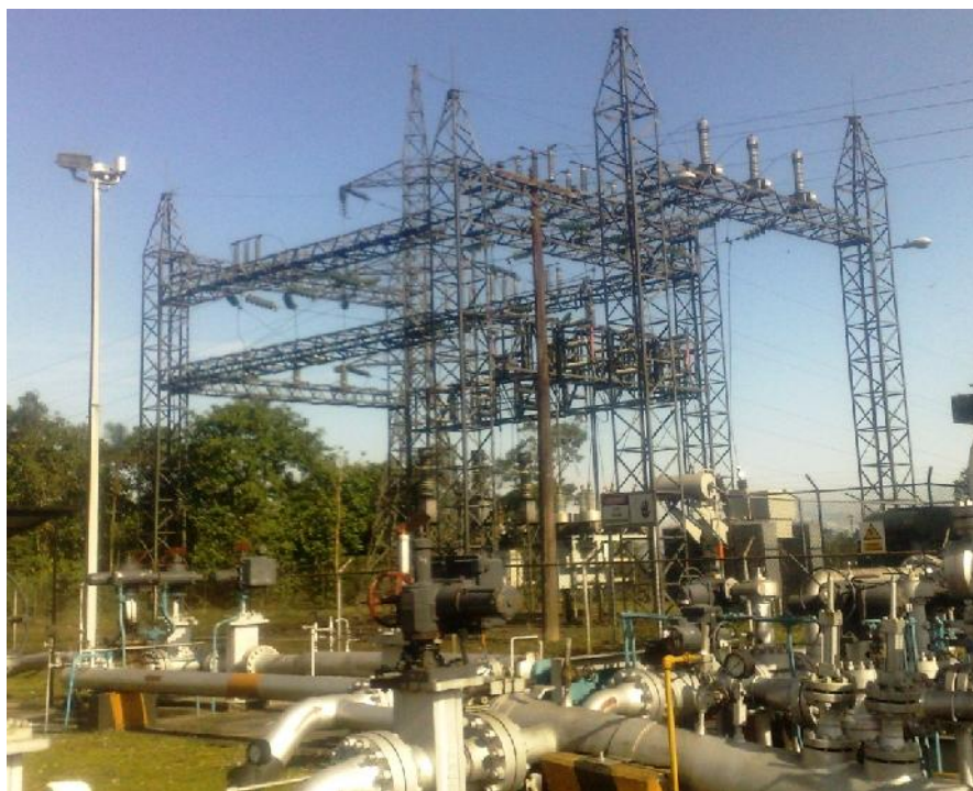
Figura 3.12. Subestación de energía eléctrica de la planta.
