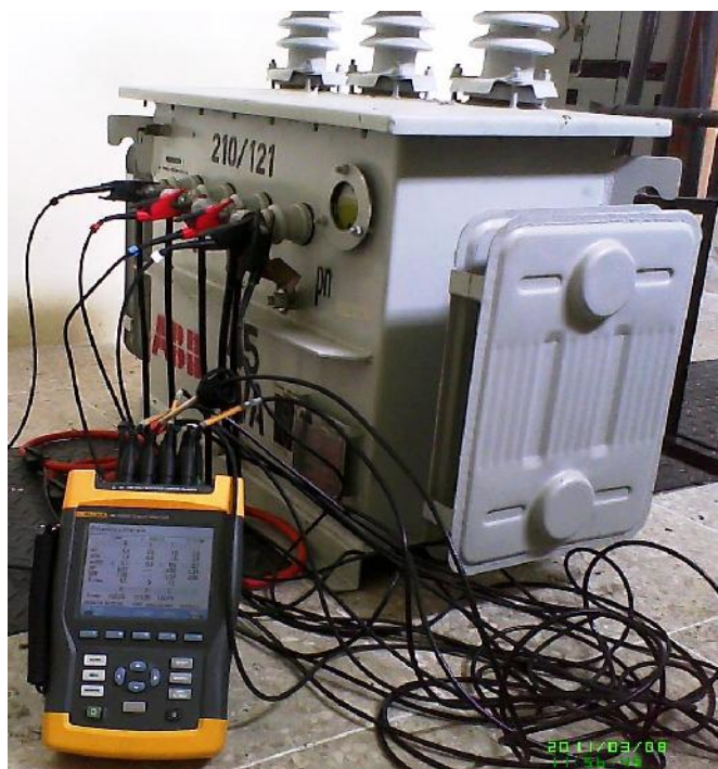
Figura 3.23. Obtención de datos con el analizador de calidad de energía T435.
