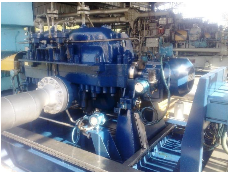
Figura 3.32. Bomba centrífuga axial multietapa P-204.
