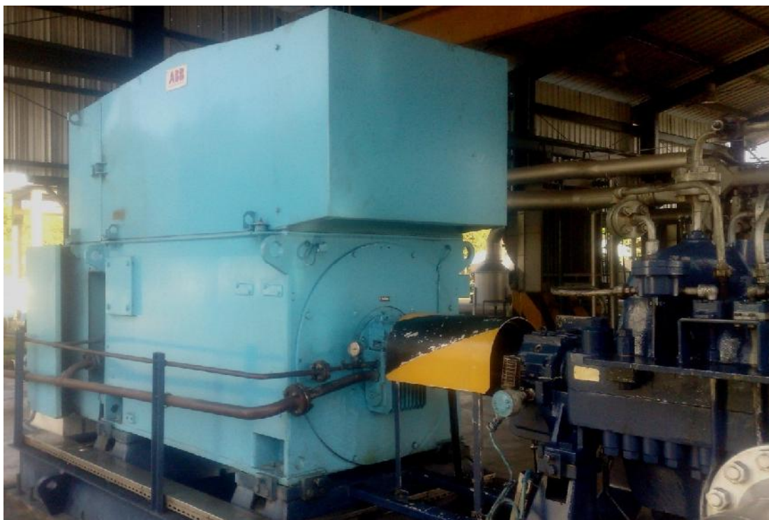
Figura 3.15. Motor eléctrico de inducción para generar movimiento rotativo a la bomba multietapa.
