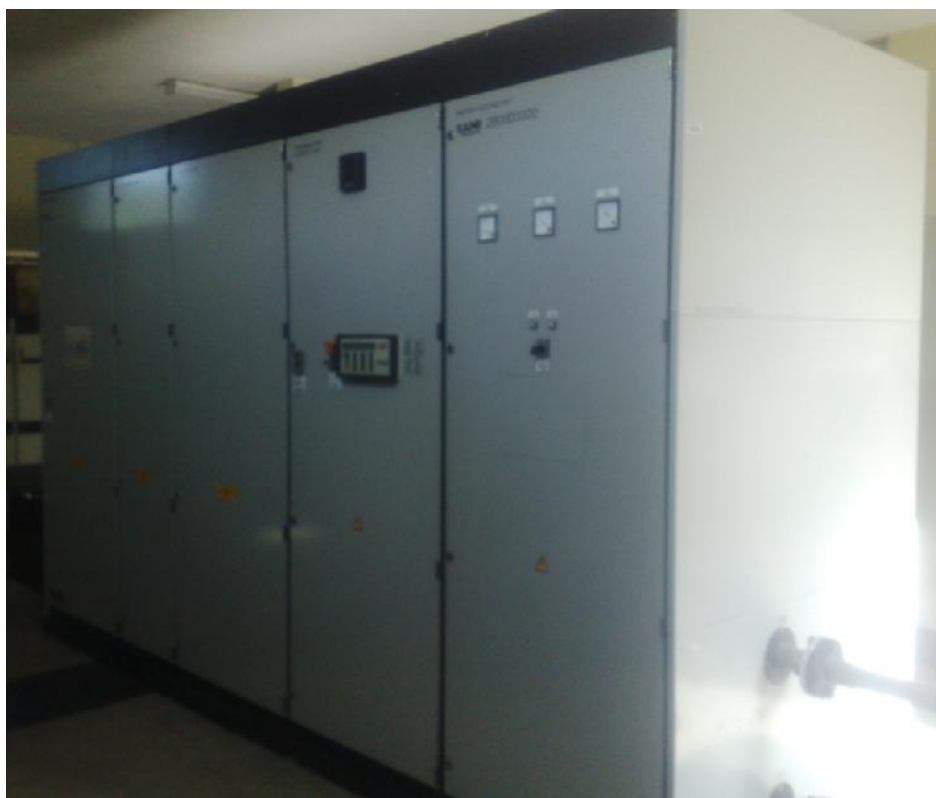
Figura 3.16. Panel en el que se encuentra el display en el que se muestran los parámetros de corriente del motor eléctrico ABB.
