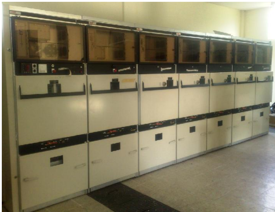
Figura 3.13. Panel electrónico donde se recepta los datos del transformador de 13000V.
