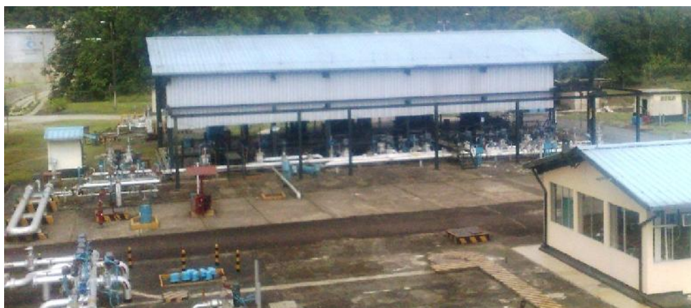
Figura 3.2. Galpón donde se encuentra el grupo de bombeo.
