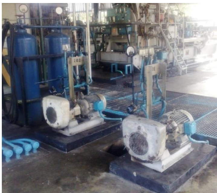
Figura 3.29. Compresores acoplados a sus respectivos motores eléctricos.
