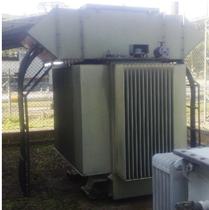
Figura 3.19. Transformador I (T1).
