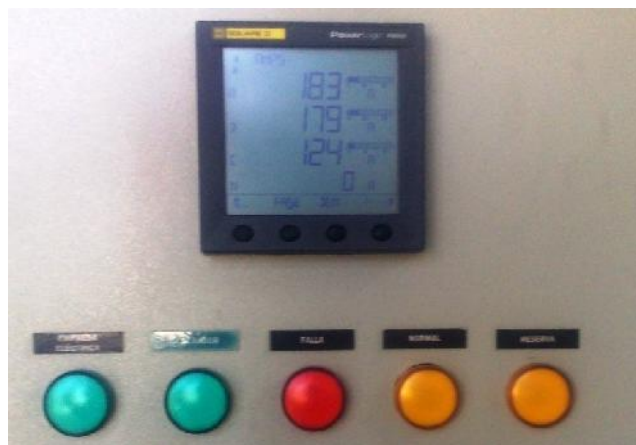
Figura 3.26. Panel en el que se muestran los datos de voltaje, corriente y otros parámetros que consume la estación.
