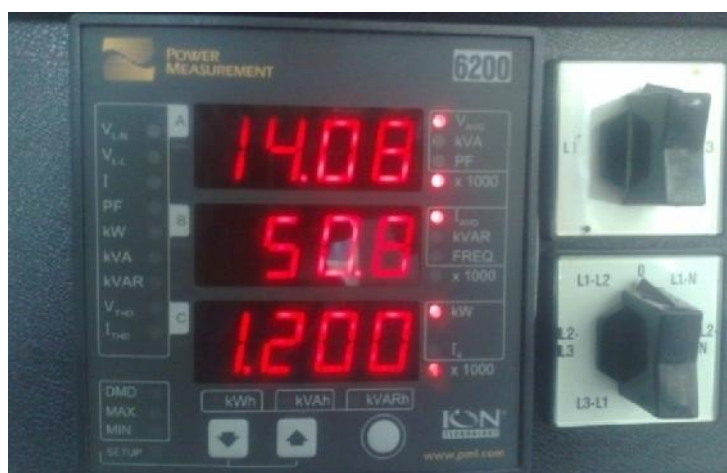
Figura 3.20. Modulares de control y monitoreo en el que se muestra datos de importantes de la subestación eléctrica.
