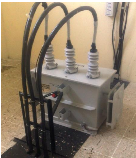
Figura 3.24. Transformador de 45 KVA.
