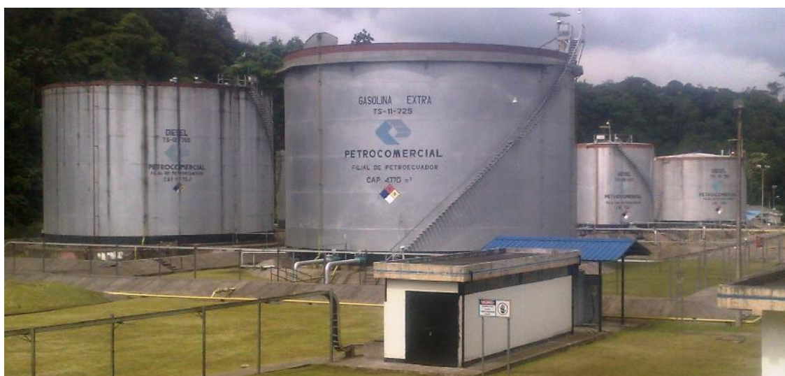
Figura 3.1. Tanques de almacenamiento.
