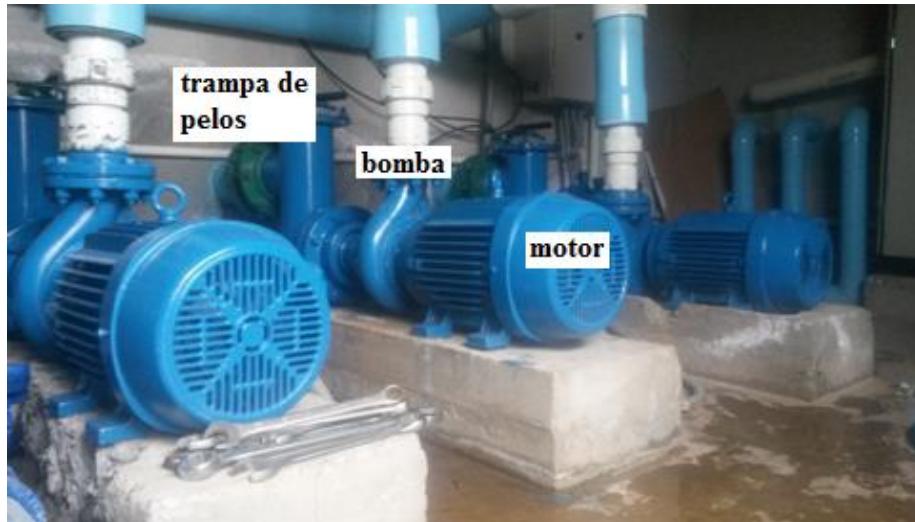
Figura 15-3. Muestra las trampas de pelo, motores, bombas que elevan el agua.
