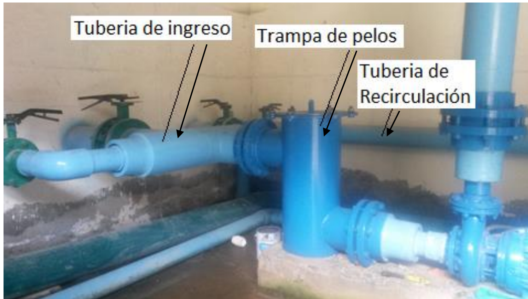
Figura 5-3. Filtración del agua de la cisterna y de recirculación en la trampa de pelos y posterior envío al filtro de arena.
