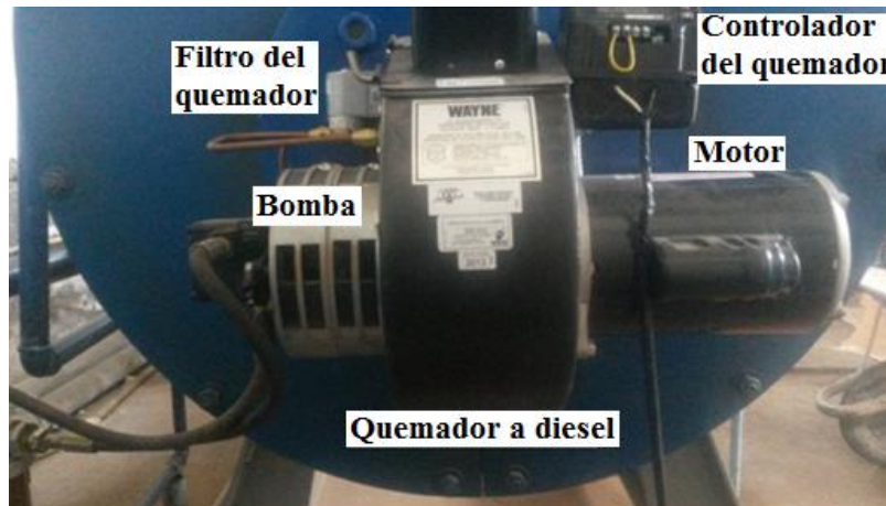
Figura 20-3. Vista lateral del caldero puede apreciar el quemador diésel.
