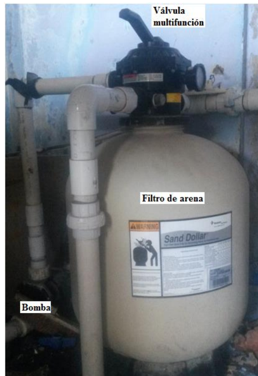
Figura 23-3. Filtro de arena y bomba
