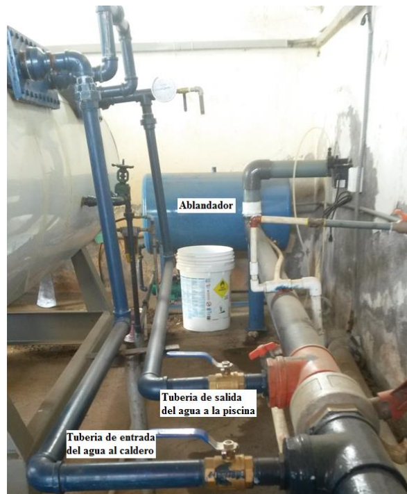
Figura 21-3. Parte posterior del caldero.
