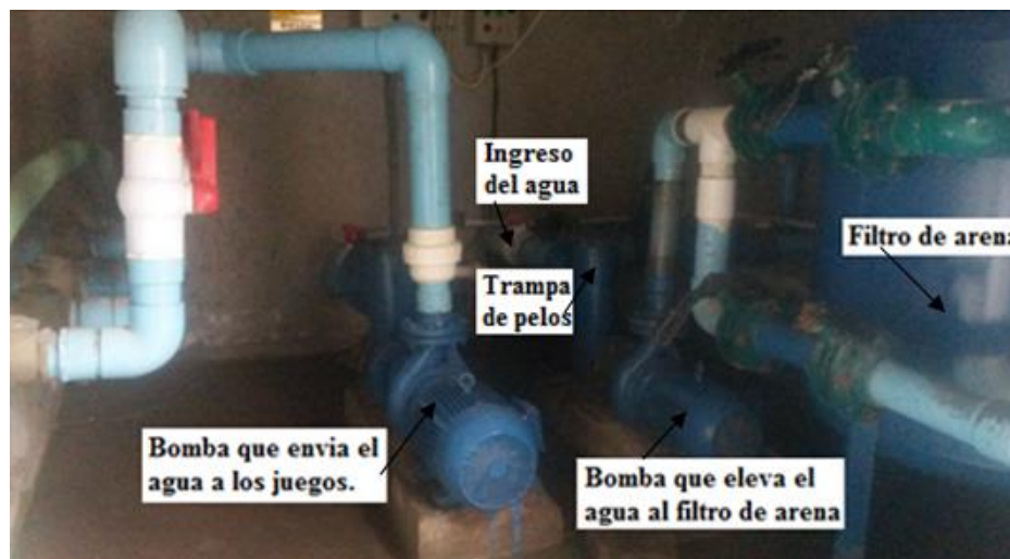
Figura 18-3. Equipos en la casa de máquinas de la piscina interactiva.
