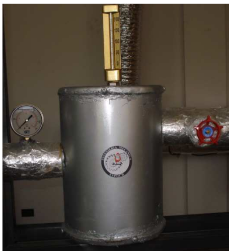
Figura 3.5: Cámara de expansión
