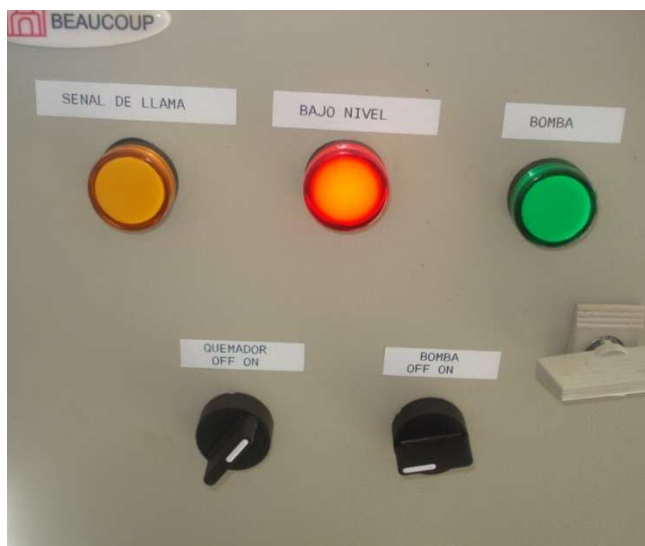
Figura 4.18: Tablero de control.
