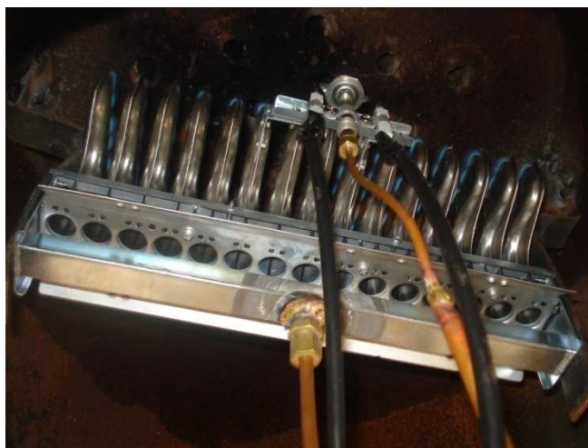
Figura 4.20: Quemador de la caldera.
