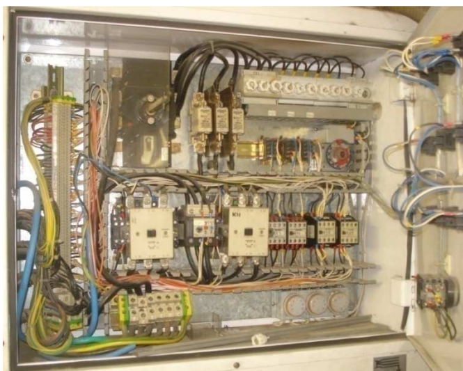
Figura 4.1: Tablero de control.
