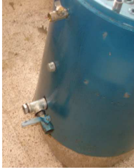
Figura 6.3: Válvula de purga de la caldera.
