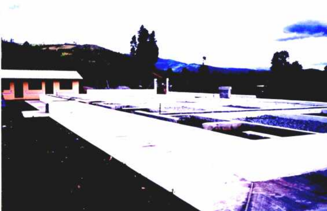
FIGURA 3.2. TANQUES DE FILTROS DE ARENA Y CLORACION.
