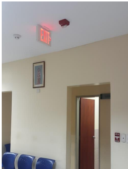
Figura 4-3: Detector de humo y palanca de activación de alarma de incendio
