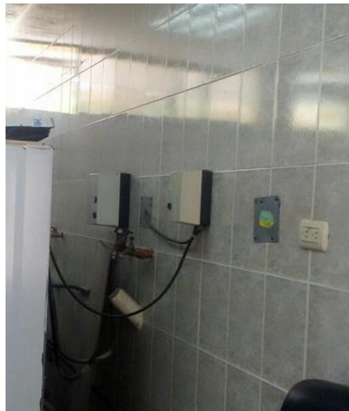
Figura 20-3: Cajas de alimentación de corriente eléctrica
