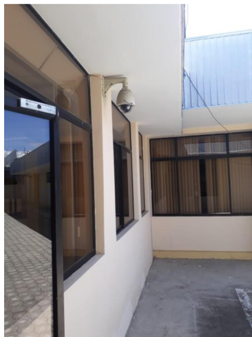
Figura 10-3: cámaras de video vigilancia
