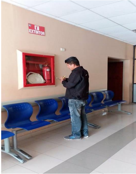
Figura 3-3: Gabinete en caso de incendio
