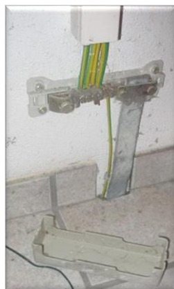
Figura 54. Conexión a tierra
