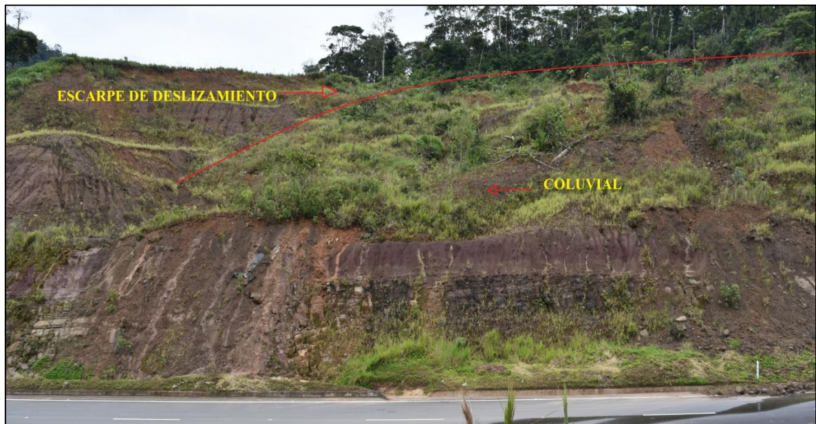
Figura 33-4 Deslizamiento rotacional Km. 4+710
