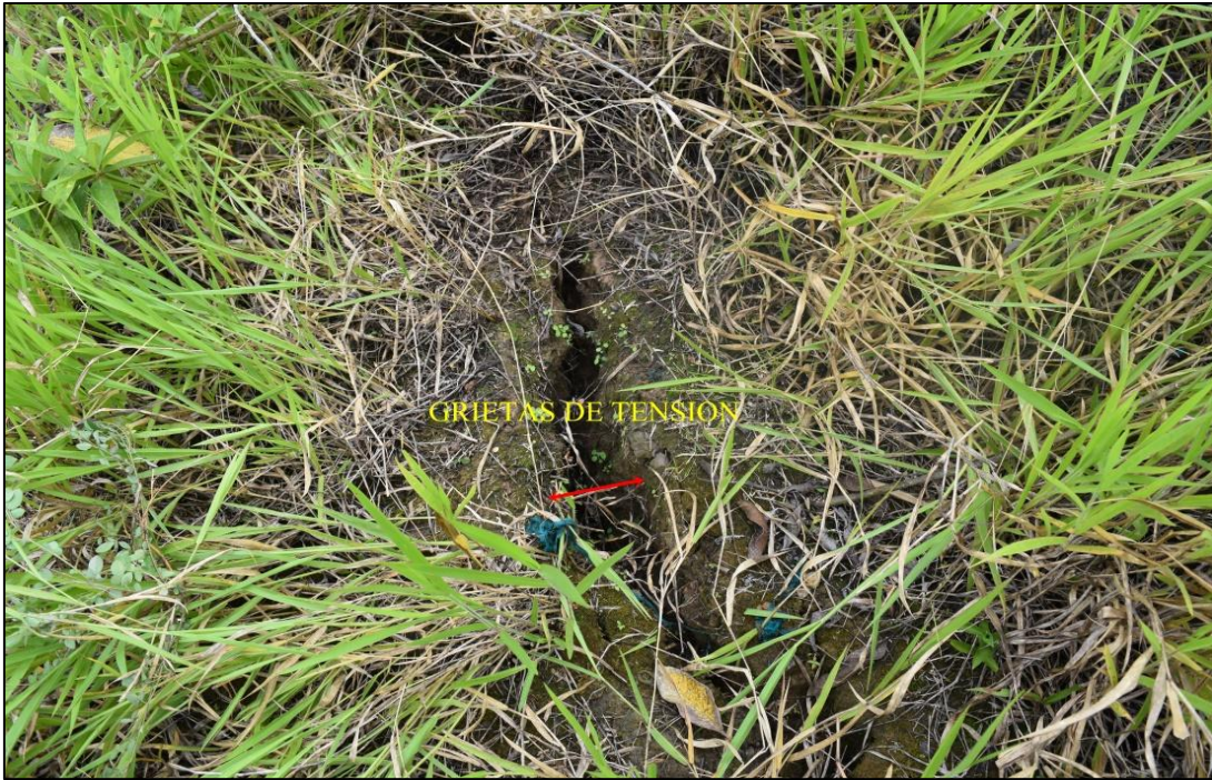
Figura 30-3 Grietas de extensión, lado Izquierdo del segundo asentamiento
