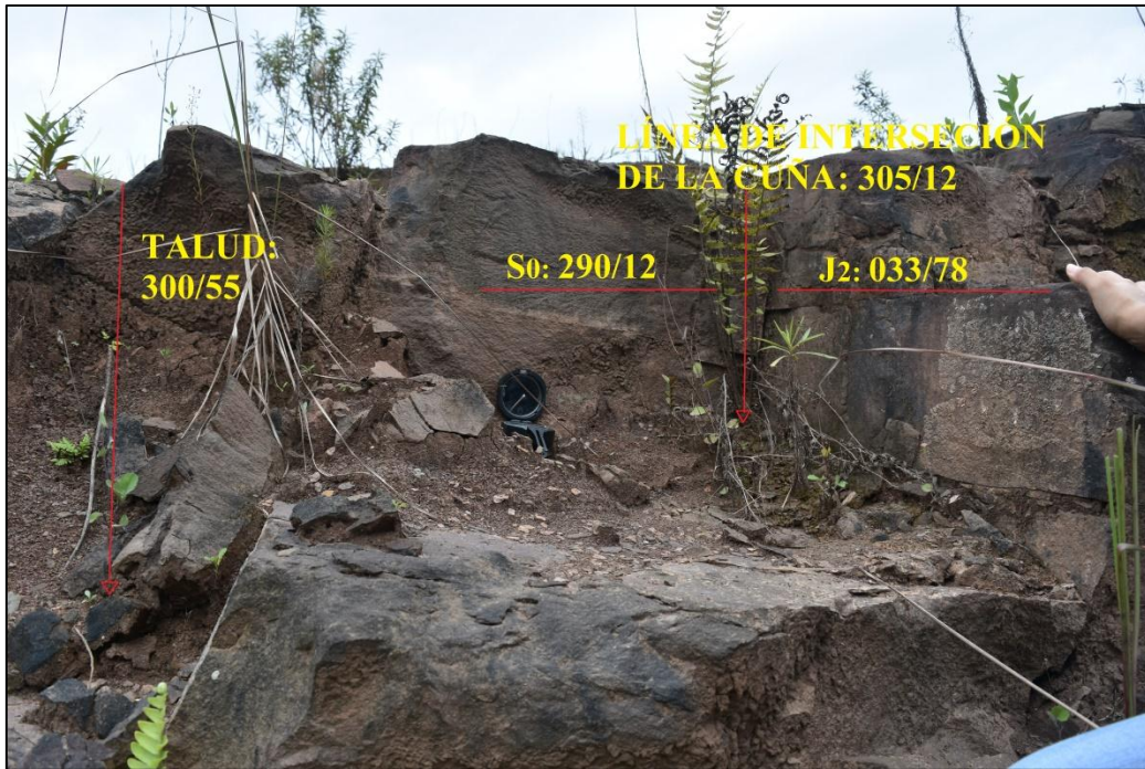
Figura 80-4 Estructuras en arenisca, talud izquierdo, abscisa 4+780, falla por cuña
