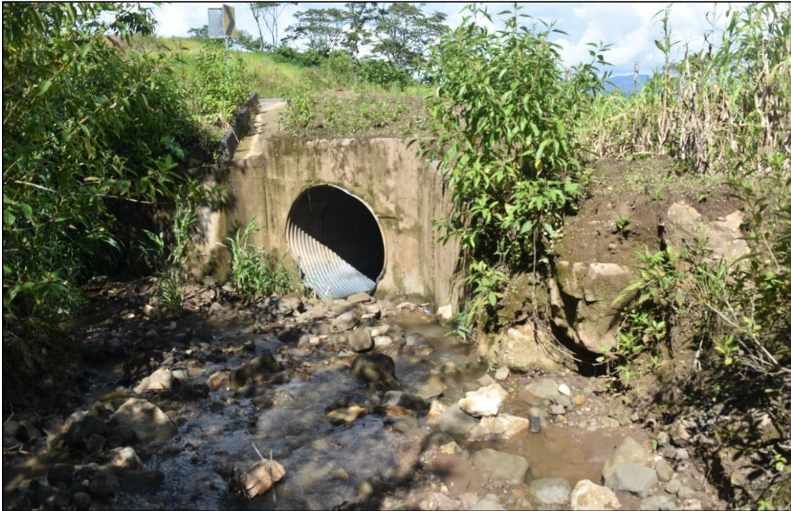
Figura 31-3 Desborde de agua fuera de la alcantarilla del segundo asentamiento
