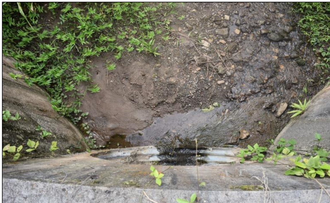
Figura 28-3 Desborde de agua fuera de la alcantarilla primer asentamiento
