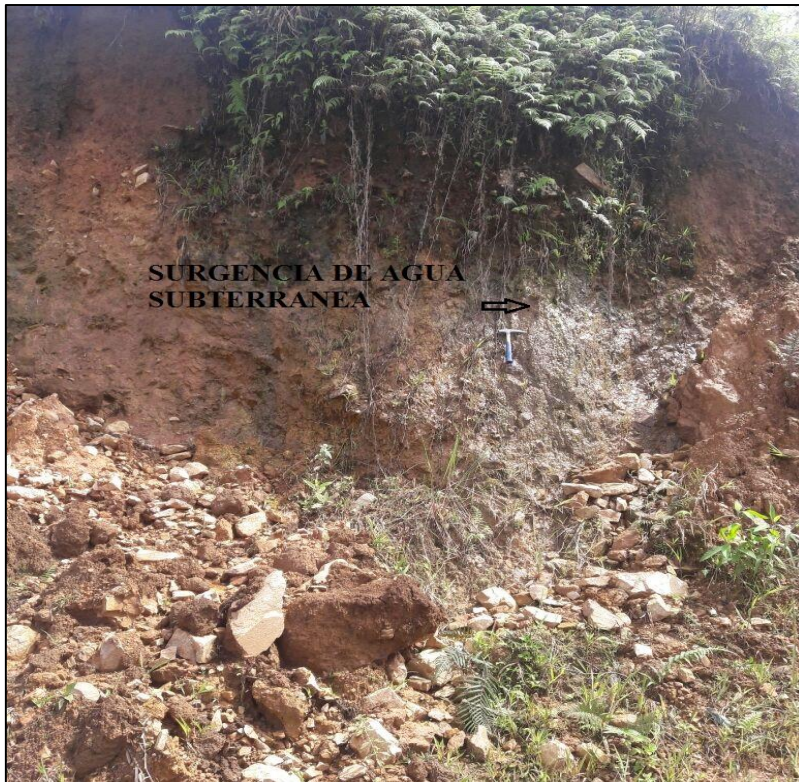
Figura 21-3 Surgencia de agua subterránea, abscisa 7+440
