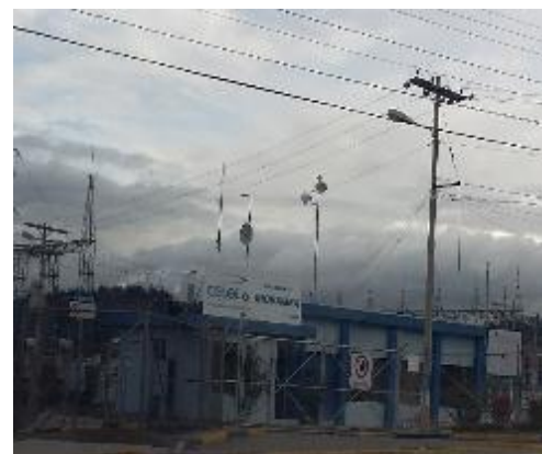
CELEC EP subestación Riobamba
