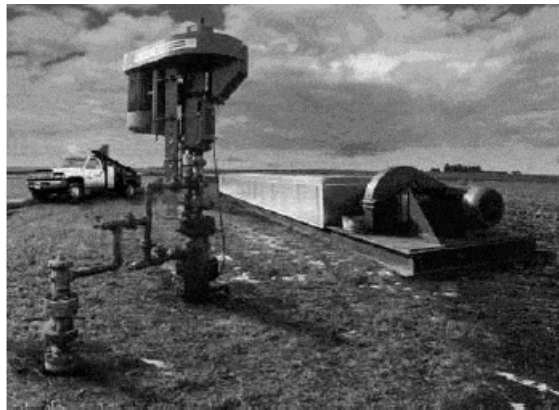
Figura 4: Bomba PCP Instalación de Superficie
