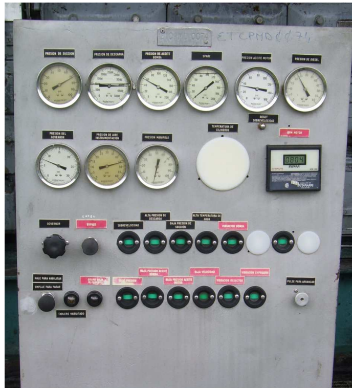
Figura 33: Tablero de Control Unidad de Bombeo Power Oil 3
