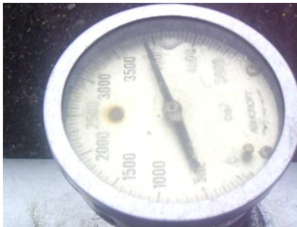
Figura 39: Manómetro Ashcroft (Presión de Descarga)
