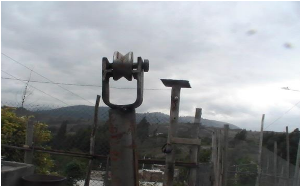
Gráfico 14. Adición de las rieles para el sistema de rodadura de los marcos de sujeción.
