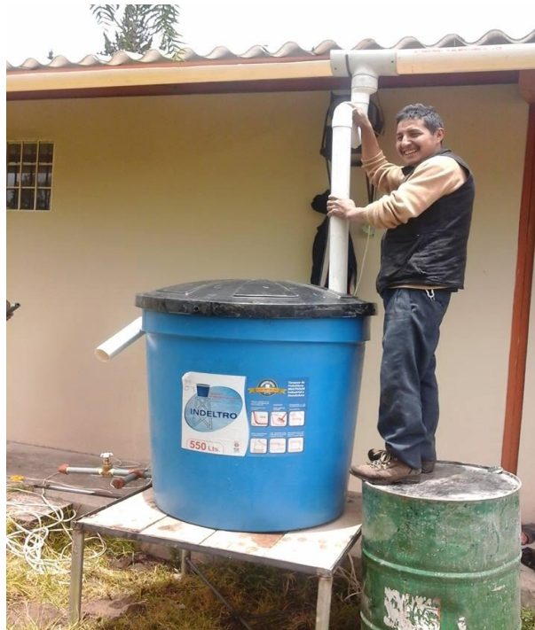
FOTOGRAFÍA 7: Implementación del sistema de conducción y almacenamiento
