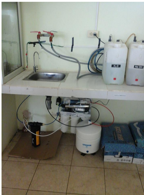
FOTOGRAFÍA 11: Equipo de ósmosis inversa – desionizador instalado
