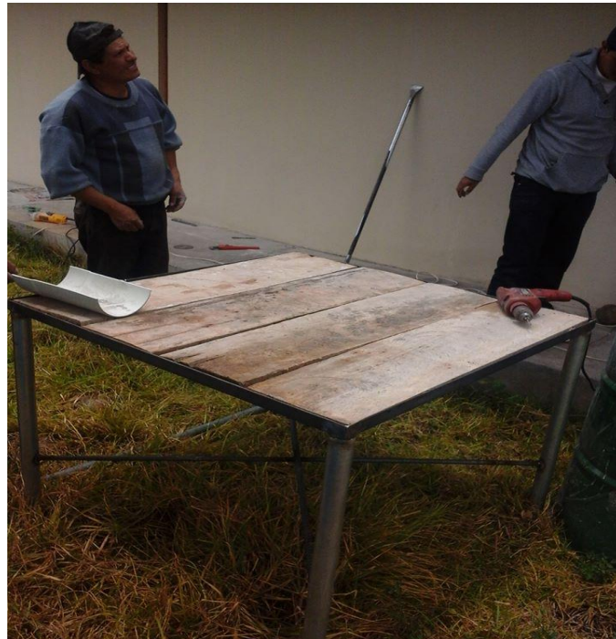
FOTOGRAFÍA 6: Soporte del tanque de almacenamiento
