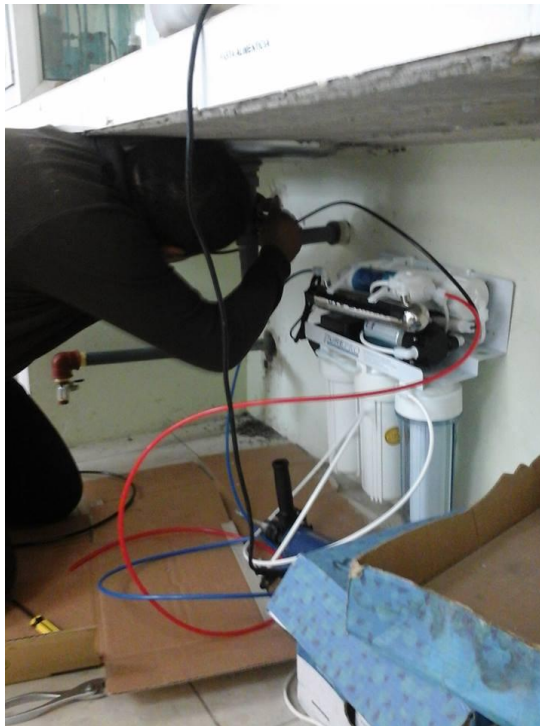
FOTOGRAFÍA 10: Instalación del equipo de ósmosis inversa – desionizador
