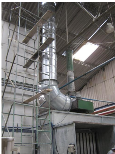
Figura 54: Chimenea provisional de cabina de esmaltado con cortina.
