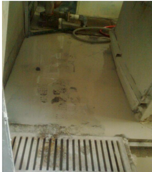
Figura 35: Esmalte derramado en el pasillo de circulación adyacente a la cabina de esmaltado convencional.
