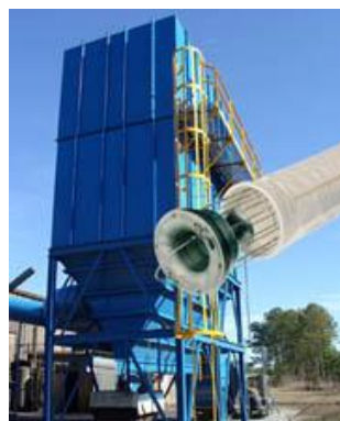
Figura 12: Instalación típica de un conjunto de filtros de manga con campo electro magnético.
