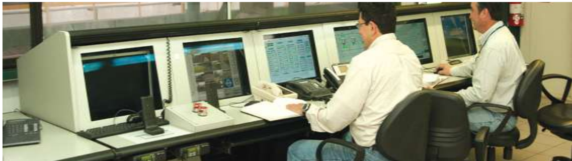
Figura 4.1 Entrenamiento en el cuarto de control
