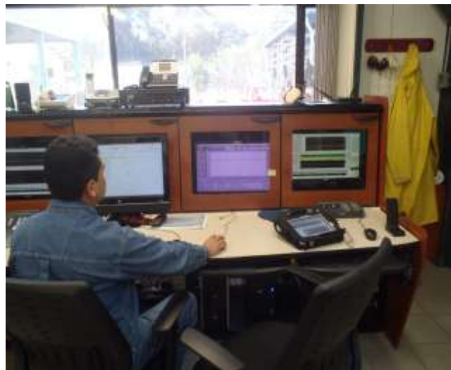
Figura 4.2 Prácticas en el cuarto de control
