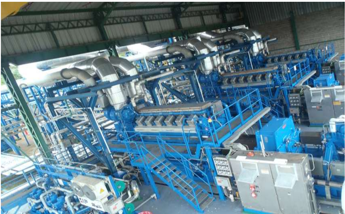
Figura 1.2. Imagen de los Motores de Combustión Interna Wartsila VASA 12V 32 LN montados en paralelo de la Estación Cayagama.
