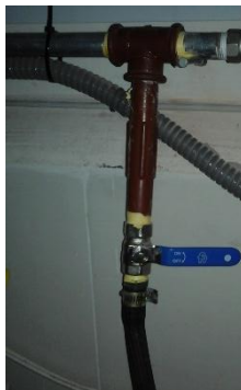
Figura 38-2: Tubería de entrada
