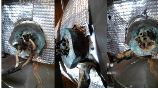
Figura 6-2: Capa de cerámica soldada al tanque de ebullición
