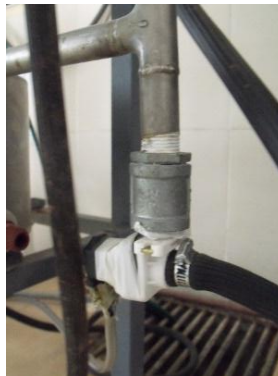
Figura 5-2: Instalación de electroválvulas
