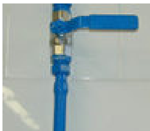
Figura 67. Alimentación de aire comprimido
