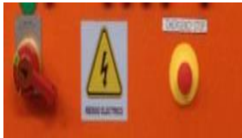
Figura 64. Parada de emergencia
