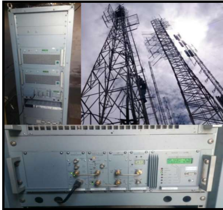
Figura 5-2: Estación repetidora ubicada en el cerro cache (Riobamba). Realizado por: Valle, Felipe; 2018.
