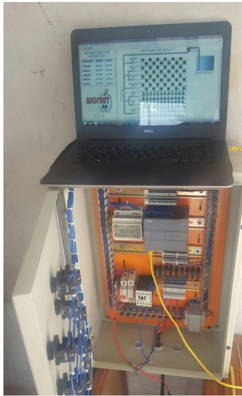
Figura 4-4 Tablero de control implementado Autor: GARCÍA, Eduardo. 2016
