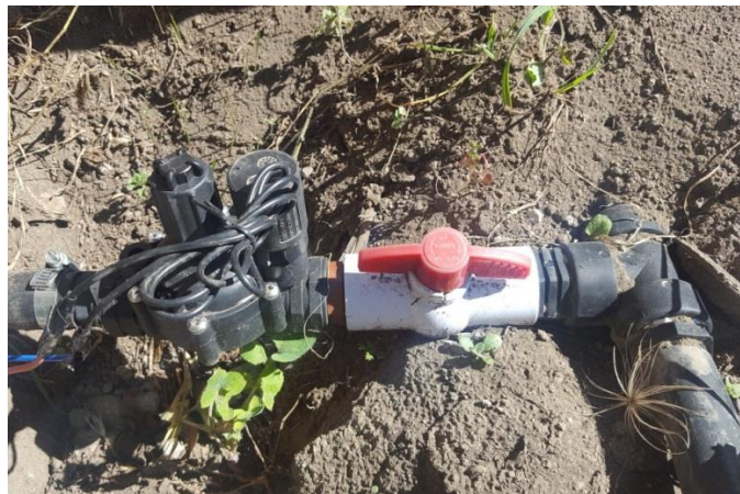
Figura 5-4 Válvula Selenoide - Instalada Autor: GARCÍA, Eduardo. 2016
