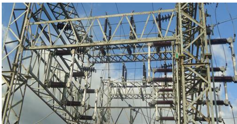
Figura 14. Barras colectoras a 69 kV de la Subestación Dos de la EERSA
