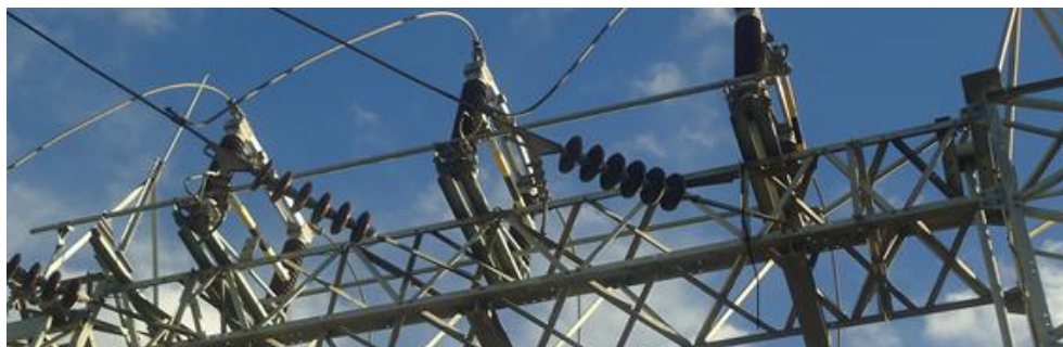
Figura 15. Seccionador o cuchillas de la Subestación Dos de la EERSA
