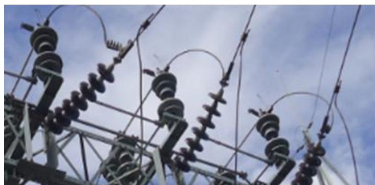
Figura 17. Conectores de la Subestación Dos de la EERSA
