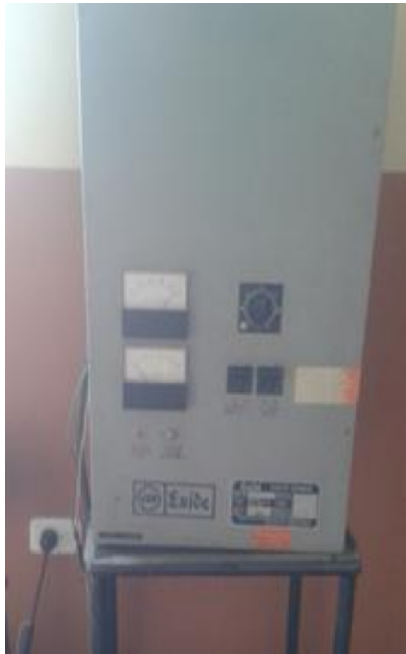
Figura 21. Rectificador de la Subestación Dos de la EERSA
