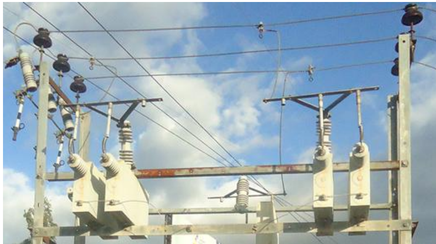
Figura 18. Banco de capacitores de la Subestación Dos de la EERSA
