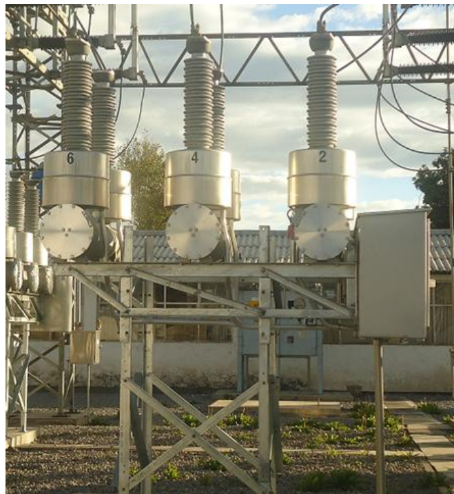
Figura 12. Interruptor SF6 de la Subestación Dosde la EERSA
