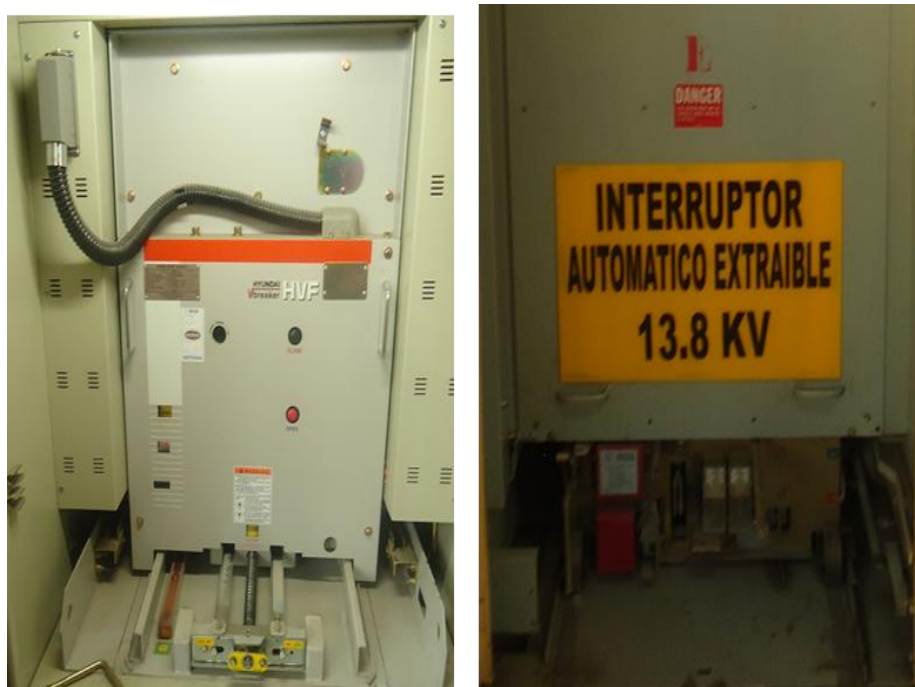
Figura 13. Interruptor automático extraíble de la Subestación Dos de la EERSA
