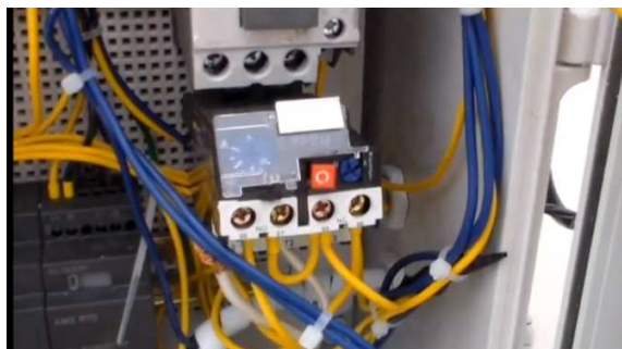
Figura15. Relé térmico de la Bomba
