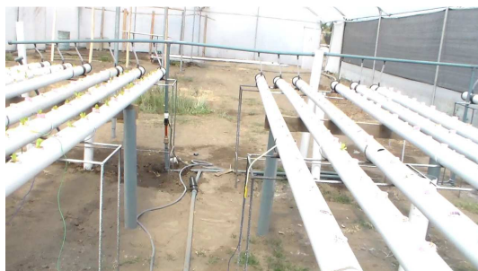
Figura III.18. Tubería de distribución hacia los sistemas 23
