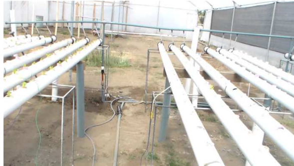
Figura 4. Tubería de distribución hacia los sistemas
