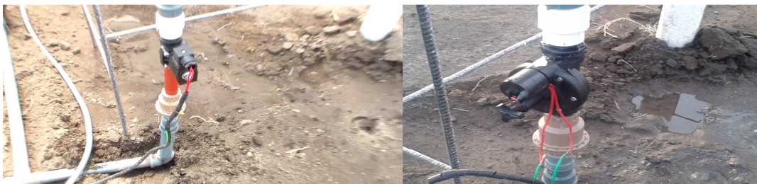
Figura IV.26. Electroválvula del sistema1 y sistema 2 33
