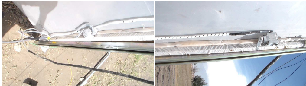
Figura IV.30. Final de carrera inferior NC/ Final de carrera superior NO 37
