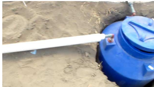
Figura7. Tubería de drenaje entrada al tanque
