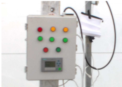
Figura IV.45. Tablero de control del Prototipo 55
