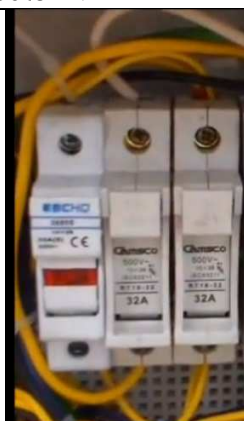
Figura15. Fusibles tablero de control
