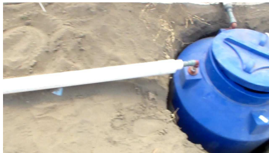
Figura III.21. Tubería de drenaje entrada al tanque 26
