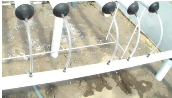
Figura6. Tubería de drenaje de salida de los canales
