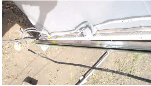
Figura12. Final de carrera inferior NC
