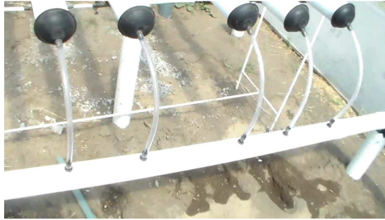
Figura III.20 Tubería de drenaje de salida de los canales 25
