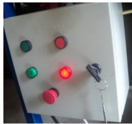
Figura 66. Gabinete de protección y botonera
